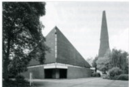
Oben: St. Barbara-Kirche. Diese Kirche mußte am 23. Oktober 1965 aufgrund von Bergschäden gesprengt werden. Es drohte Einsturzgefahr.
