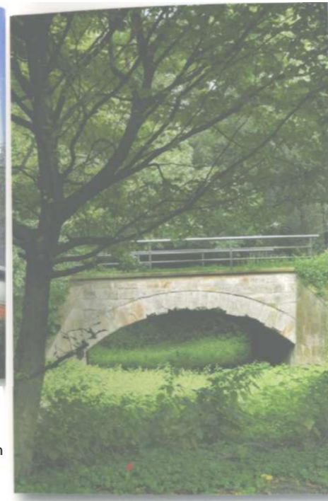
Steinbrücke über die Fleuthe, 1853 Natursteinkonstruktion, L ca. 700 cm, B ca. 600 cm Teil des Gahlenschen Kohlenwegs, Dorstener Straße, Stadtgrenze Wanne-Eickel/Gelsenkirchen
